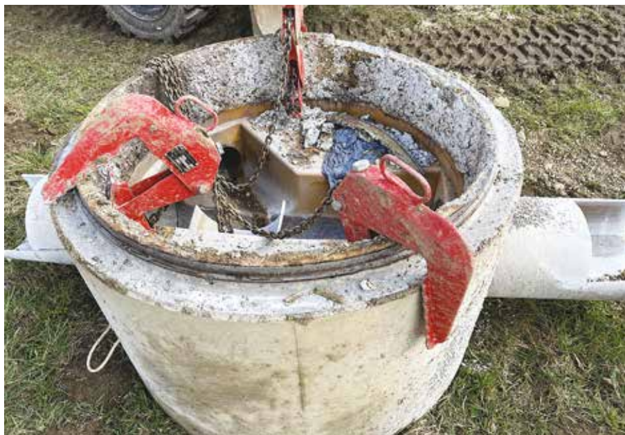
U šachet v Gratkornu biokoroze pohltila až polovinu tloušťky stěny.
