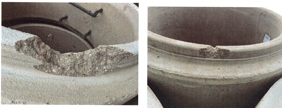
OBRÁZEK č.3 – příklad nepřijatelného poškození dříku skruže, šachtového dna, kónusu
