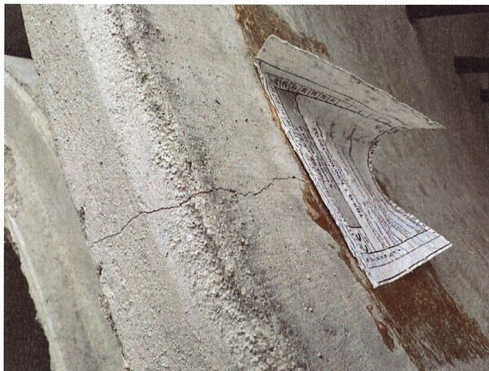
OBRÁZEK č.5 – nepřípustné trhliny
