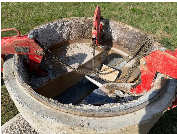
DEGRADOVANÝ SPODNÍ DÍL ŠACHTY
